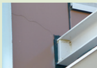
欠き込み部に亀裂が入った例①
