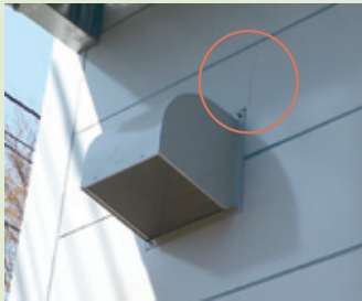
ファン取り付けでの被害
