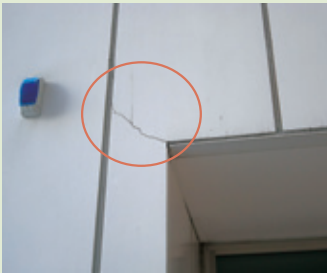
切り欠き部の被害
