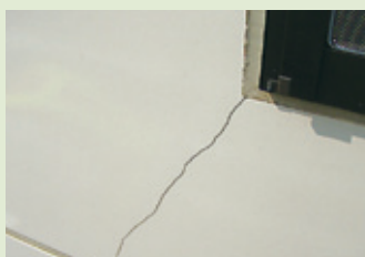
欠き込み部に亀裂が入った例②
