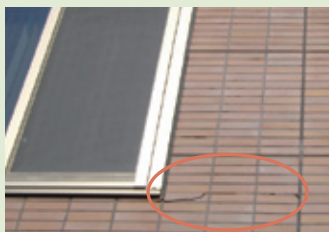
開口部に亀裂が入った例②
