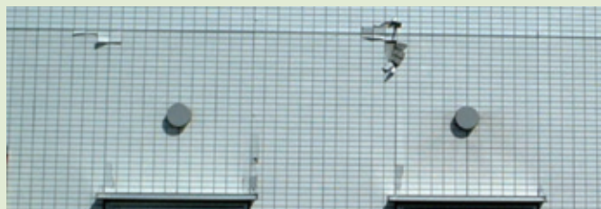
タイル浮きの例①
