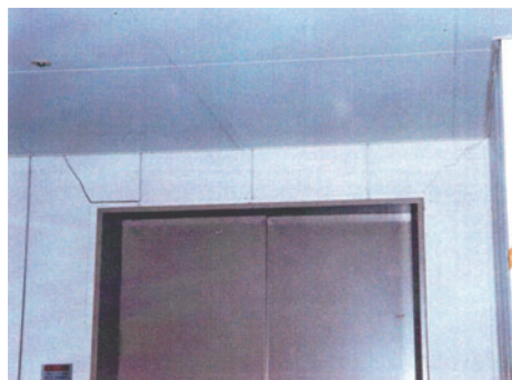
阪神淡路大震災で破損した間仕切壁
