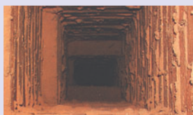
解体調査の際発見された 煙突脇の「謎の穴」
